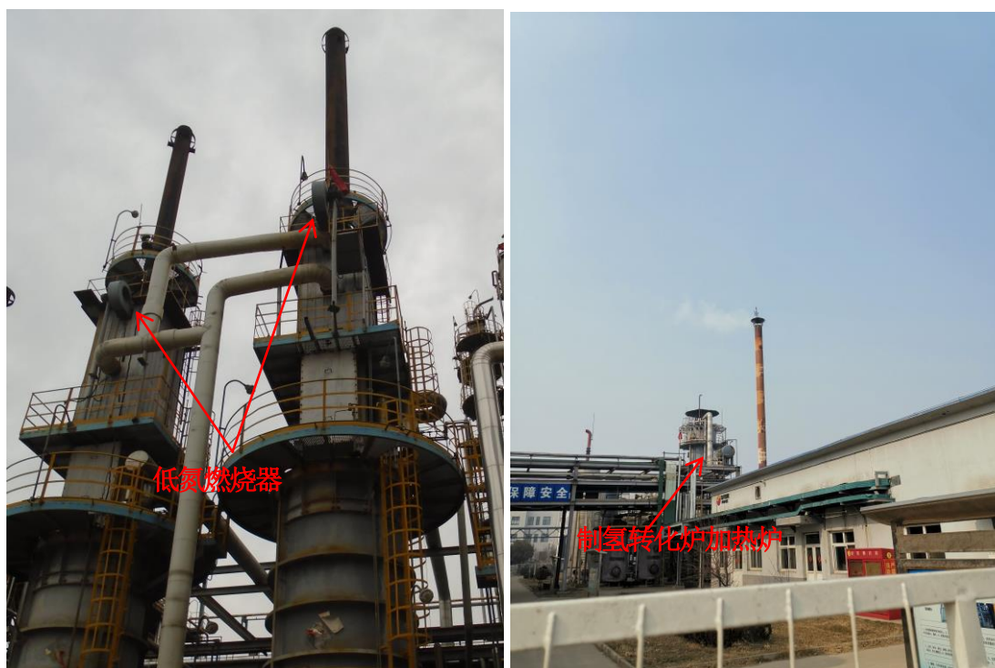
图 4-1 各加热炉废气治理设施建设情况
