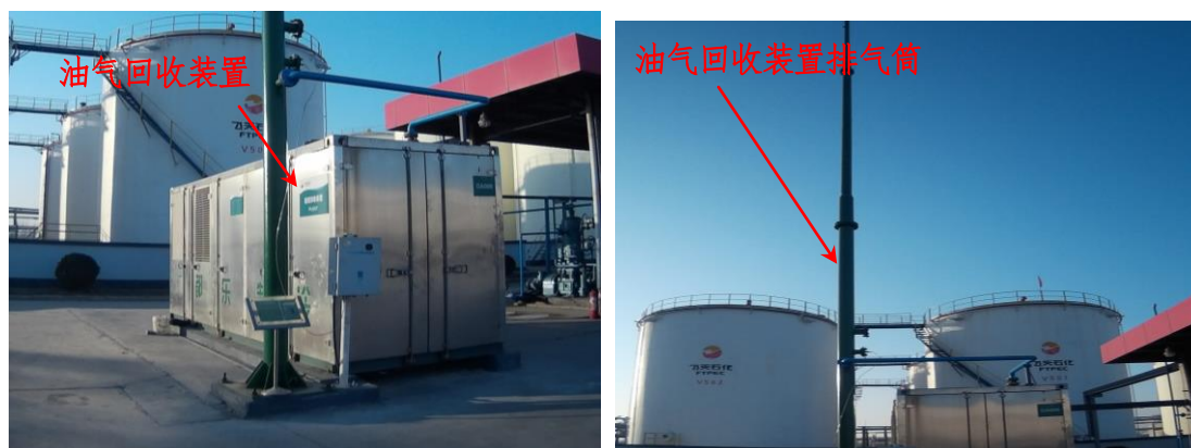
图 4-3 装卸车废气治理设施建设情况
