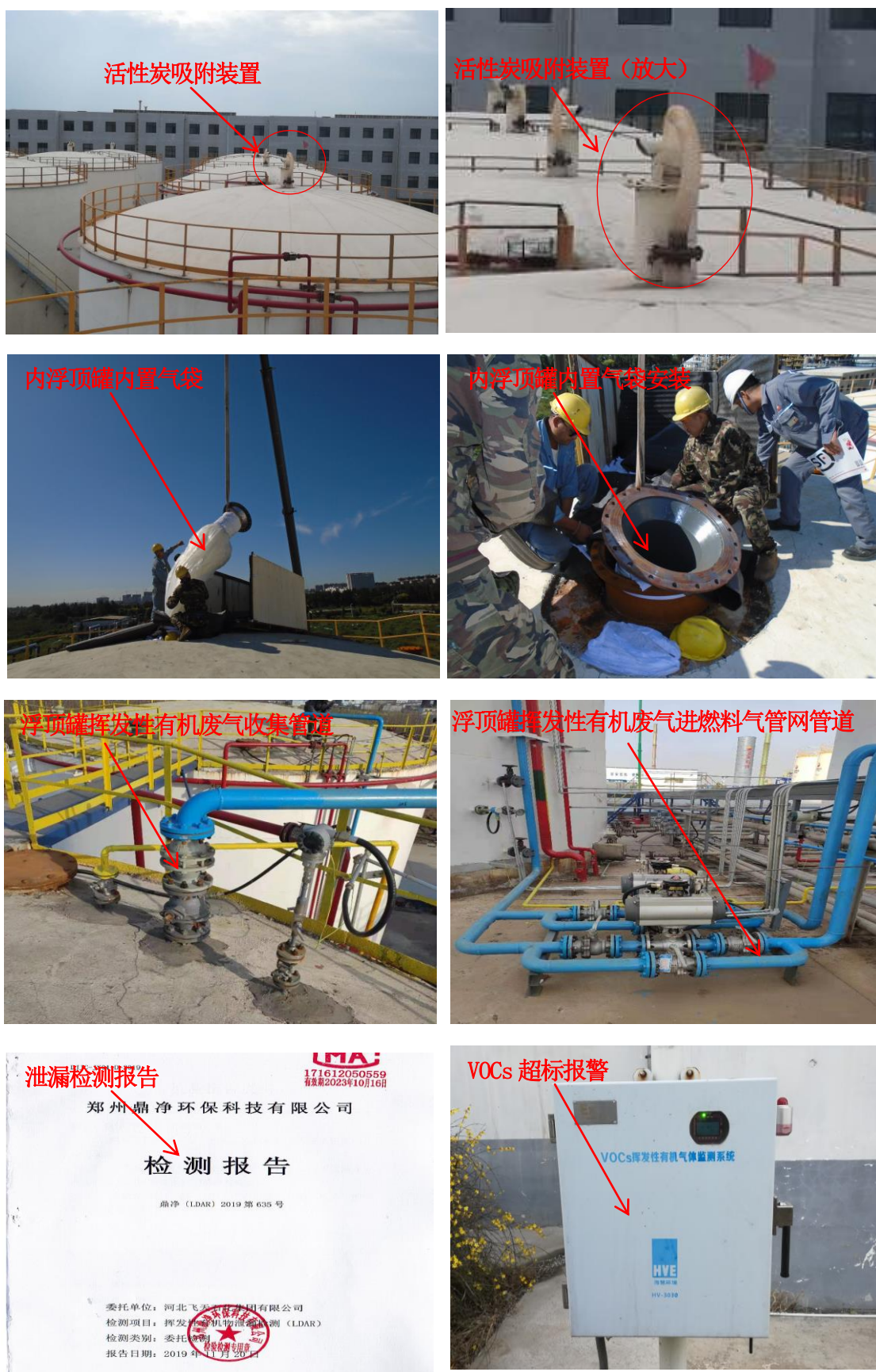
图 4-5 无组织废气治理设施建设情况
