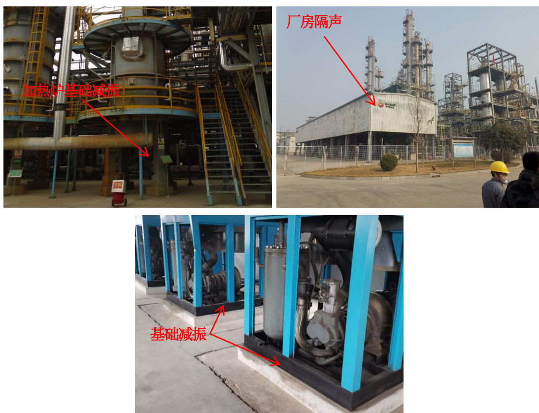
图 4-6 噪声治理设施建设情况
